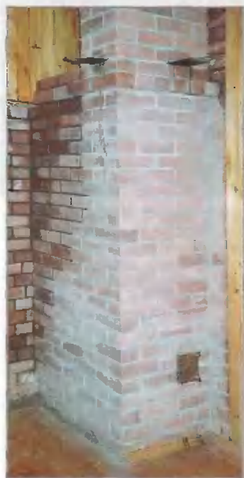
Закопченная поверхность печи — верный признак плохой тяги
